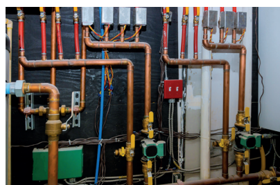
Kotle a výměníky tepla
